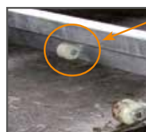
Steuerkufe an Haupträumklappe mit Rolle
