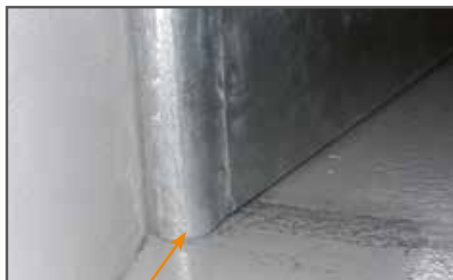
Seitliche Räumklappe Achtung: scharfe Kanten! (-> abrunden!)
