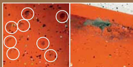
Les cloques détériorent le revêtement. Aucune cloque ne se forme avec le barrage d'humidité Vencomat.
